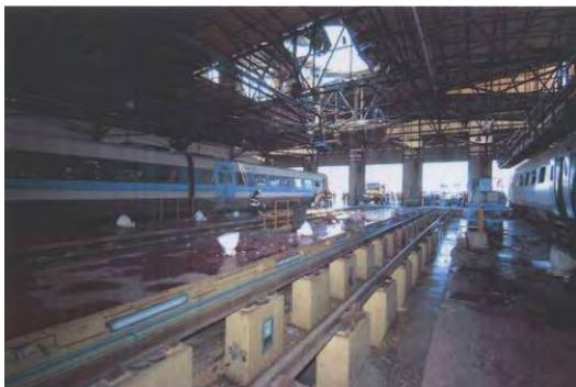
Les dégâts causés au toit du garage central de la compagnie de trains israéliens à Haïfa (16 juillet 2006).
